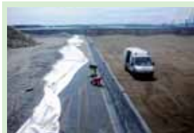
2006-2007 Хранилище промышленных отходов Швеция 8.000+42.000 m 2
